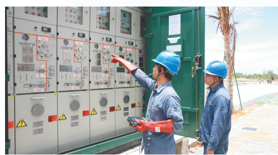
海南电网东方供电局工作人员到企业开展环网柜巡检工作。温婧伊 摄
