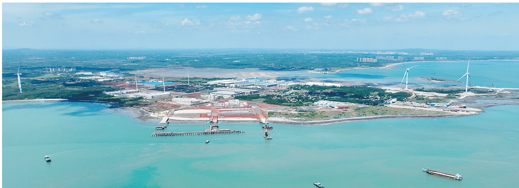
临高金牌港项目完成全部钢管桩沉桩施工，码头工程全面转入上部结构施工阶段。海南日报全媒体记者 陈元才 通讯员 胡建国 刘博文 摄
