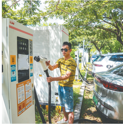
9月3日,三亚市海棠河生态公园停车场中设置便民充电站,方便新能源汽车及时充电。
